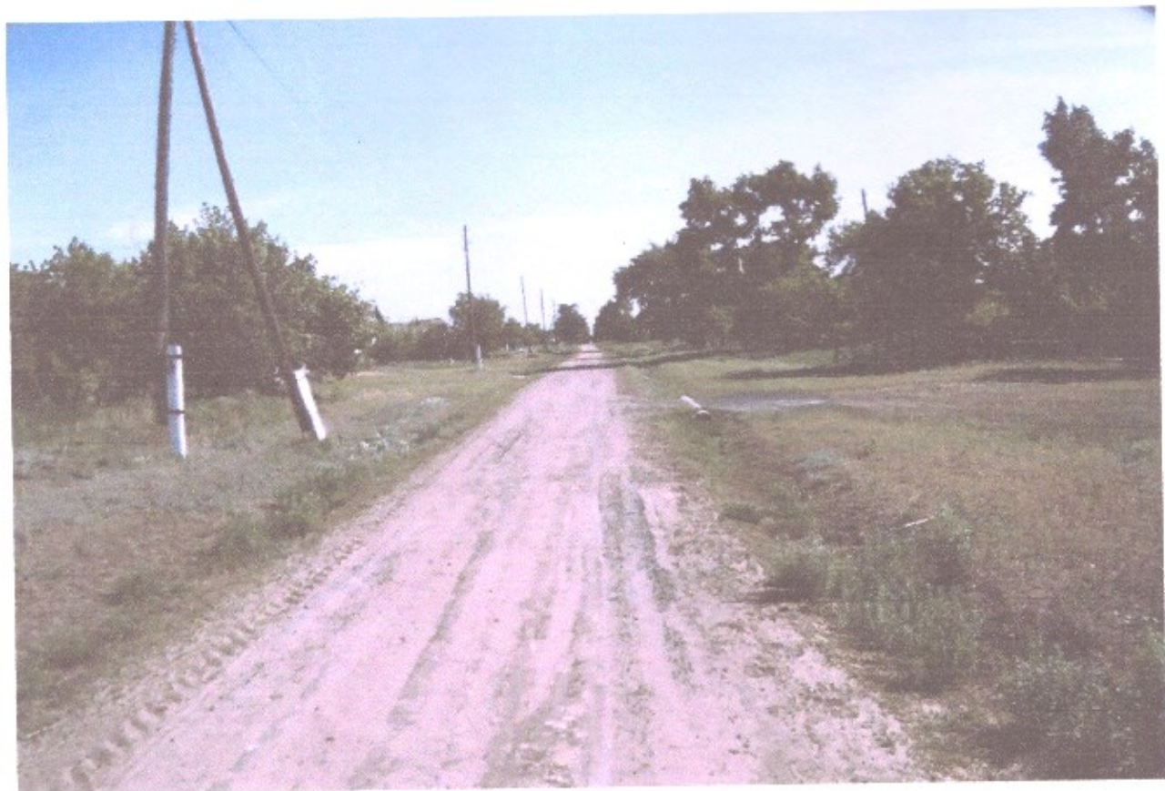
Рисунок 3.1.5– Состояние покрытия на участке ПК 0+550
