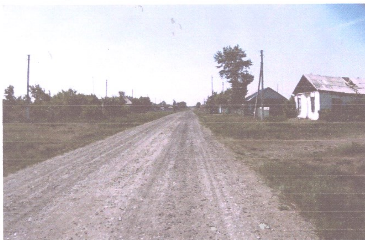
Рисунок 2.1.5 – Состояние покрытия на участке ПК 0+500
