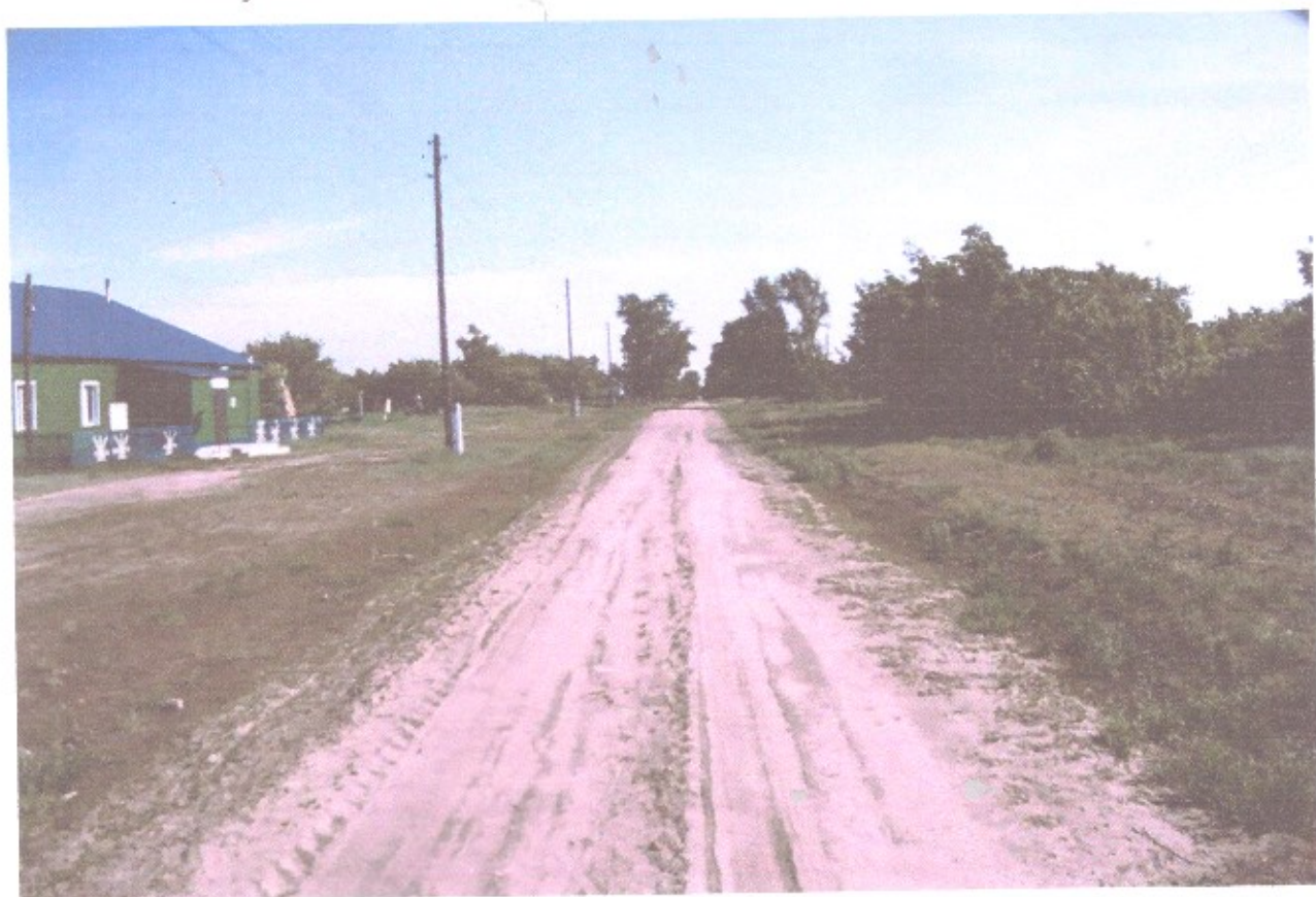
Рисунок 3.1.6 – Состояние покрытия на участке ПК 0+750
