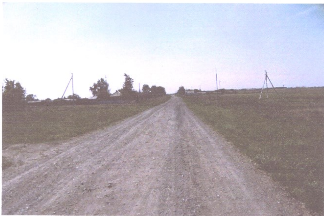
Рисунок 2.1.6 – Состояние покрытия на участке ПК 0+750
